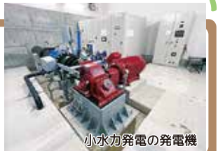
小水力発電の発電機
