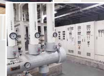
茂来館地下の冷暖房設備
