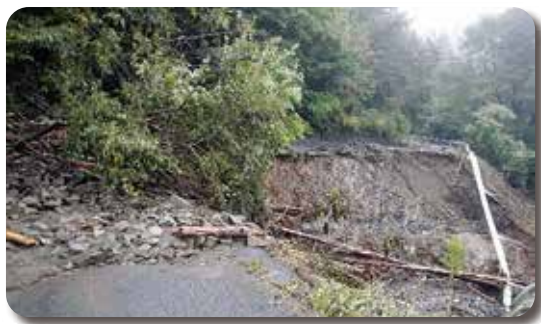
左側の沢が崩落した林道大上線
