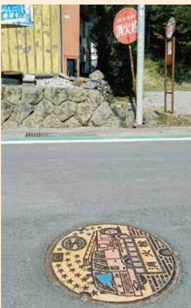
地下式消火栓
