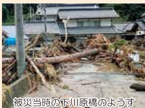
被災当時の下川原橋の様子
