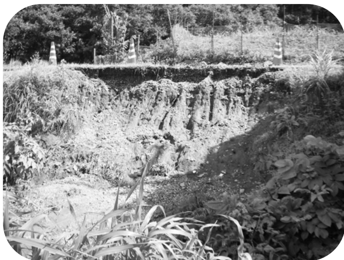
町道崩落現場
