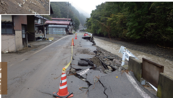
国道 299 号が大きく崩落した様子。この災害によって川の形が変わり、川底が高くなってしまったと住民は語る。
